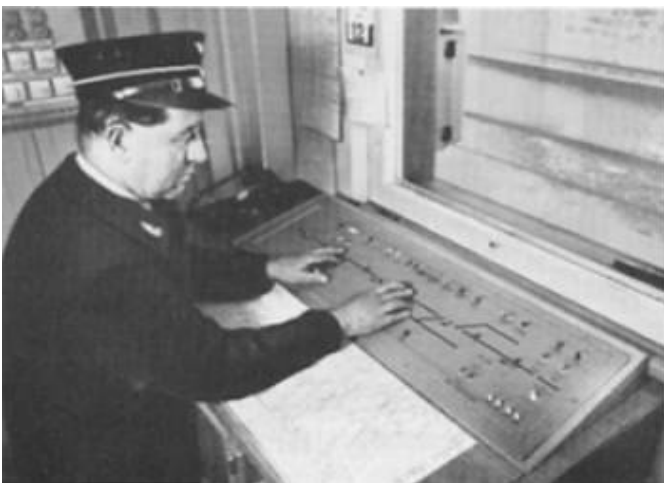
Stellpult einer Zwischenstation
